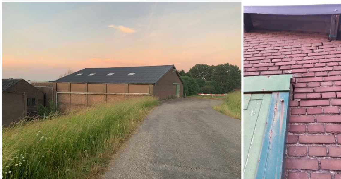
Figuur 2-1 Waalbandijk 115: overzicht loods (links) en scheuren en kieren in loods (rechts)
