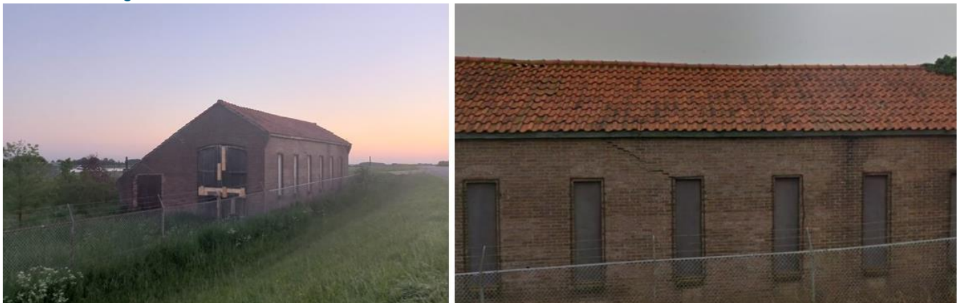
Figuur 2-3 Waalbandijk 14: Overzicht schuur (links) en pannendak en scheuren in de muur (rechts)
