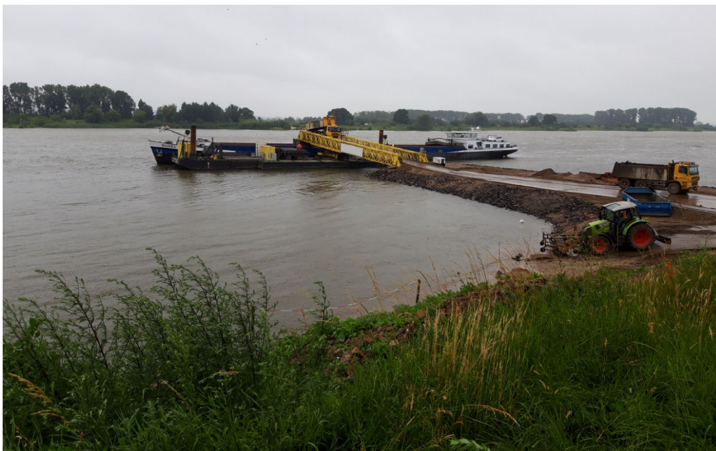
Figuur 5-1: Voorbeeld loslocatie in de rivier met een aanlegponton waarlangs schepen kunnen aanleggen met een loskraan
