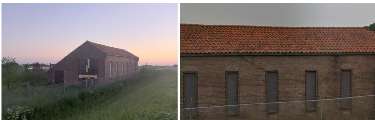
Figuur 5-11. Waalbandijk 14: Overzicht schuur (links) en pannendak en scheuren in de muur (rechts)
