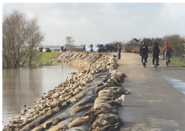
Figuur 1.1 De dijk bij Ochten met noodreparaties, tijdens extreem hoogwater van de Waal in 1995 (bron: beeldbank RWS)
