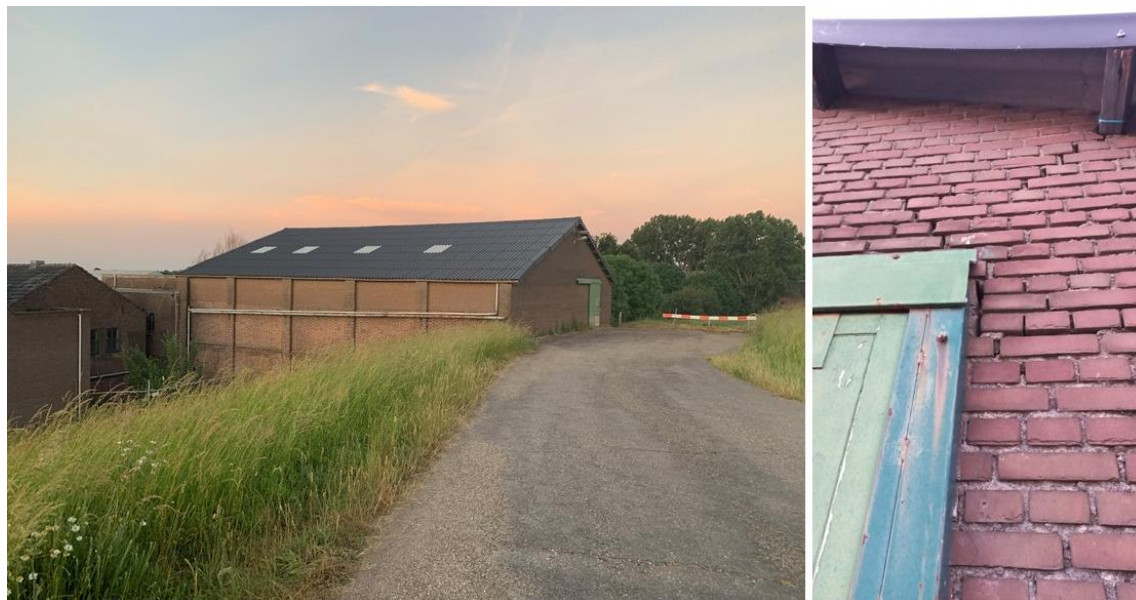
Figuur 2-1 Waalbandijk 115: overzicht loods (links) en scheuren en kieren in loods (rechts)
