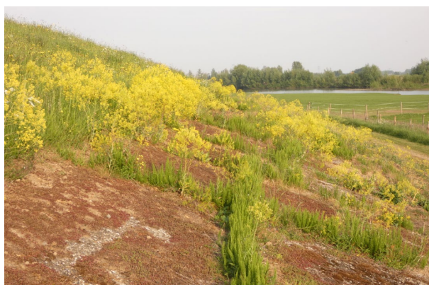
Foto 2-4. Buitentalud met betonplaten en afwijkende vegetatie met hier vooral wede
