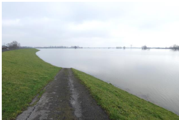
Foto 2-1. Inundatie buitendijks (winter 2020-2021). Berm en dijkvoet zijn overstromd
