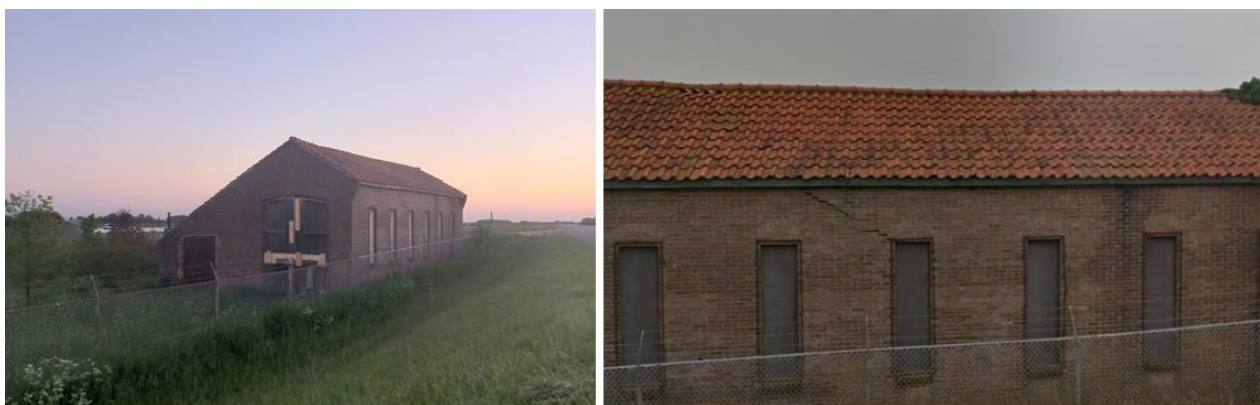
Figuur 5-11. Waalbandijk 14: Overzicht schuur (links) en pannendak en scheuren in de muur (rechts)
