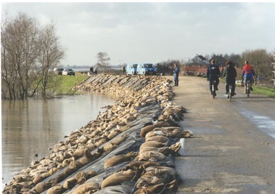
Figuur 1-1: De dijk bij Ochten met noodreparaties, tijdens hoogwater in 1995 (bron: beeldbank RWS).
